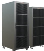
Armários de baterias
